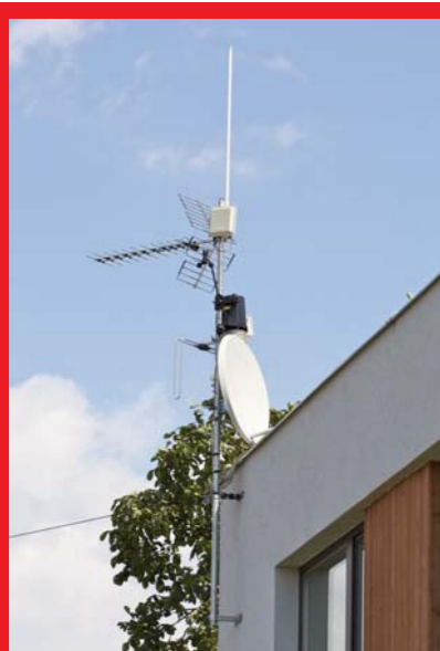
Na centrálu jsou napojena venkovní čidla, meteostanice, korouhev na vítr i stožár s anténou.
