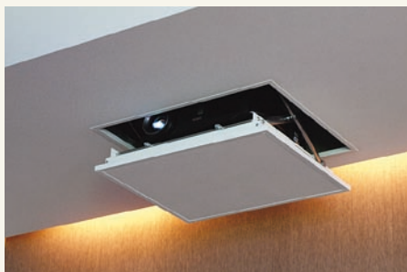
Projektor domácího kina je ukryt na výsuvné plošině v podhledu
