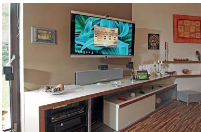
K OVLÁDÁNÍ INTELIGENTNÍ DOMÁCNOSTI MŮŽE POSLOUŽIT I OBRAZOVKA TELEVIZE FOTO INSIGHT HOME
